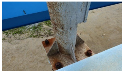
図 A-2-4 照明柱（機械構造物）のき裂推定
